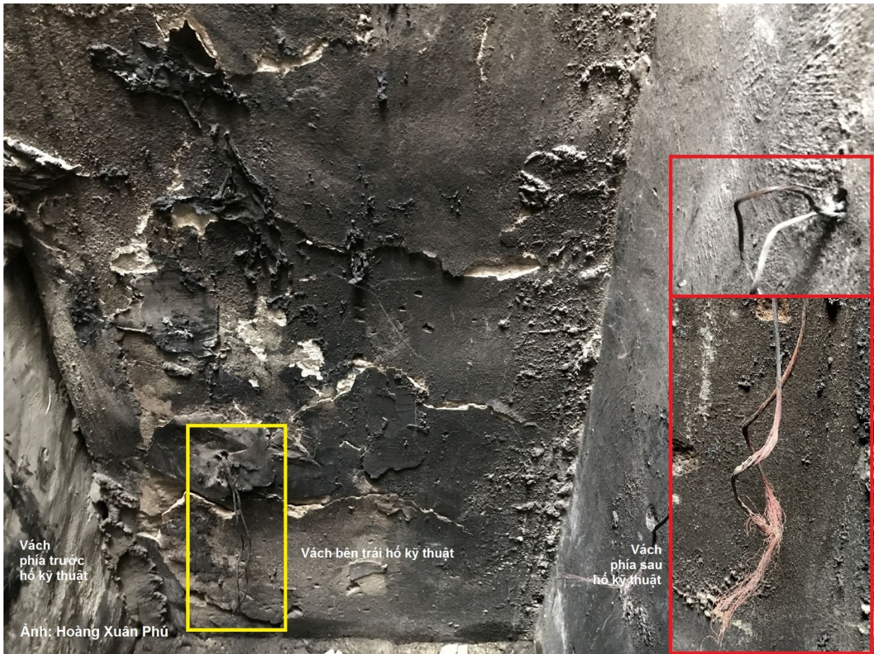
Ảnh 3.6: Bốn sợi dây điện treo lủng lẳng trong hố kỹ thuật.
