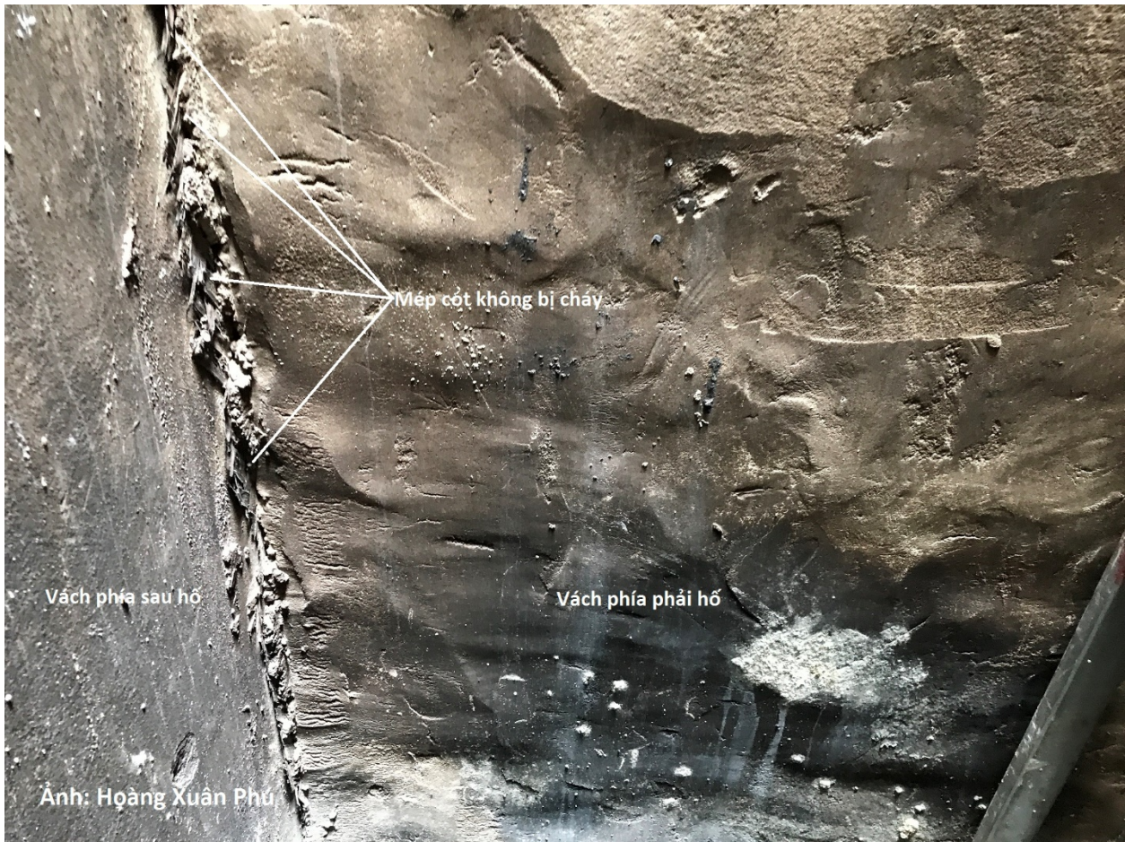
Ảnh 3.4: Mép cốt ở góc hố kỹ thuật không bị cháy.
